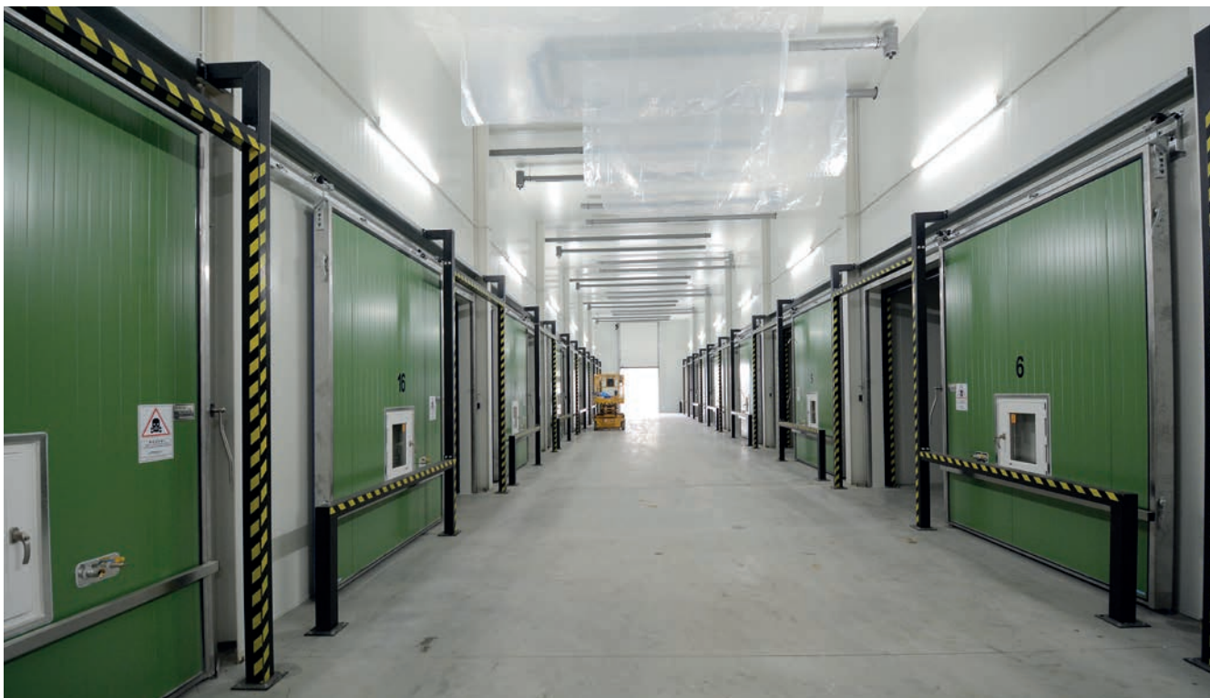
Technologická komora s vraty do jednotlivých komor
